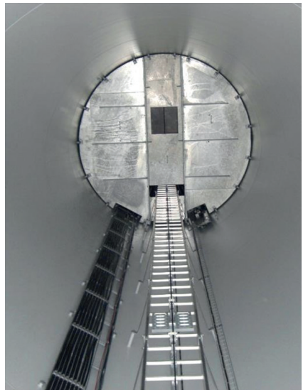
Bild 4.41 Leitungen, Steigleiter mit Seilsystem und Zwischenpodest in einem Stahlrohrturm (PowerWind 56, Quelle: [4.10])
