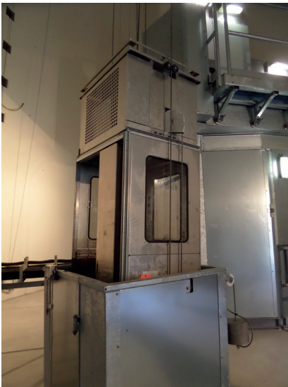
Bild 4.40 Aufstiegshilfe (Fahrkorb) in einem Fertigteil-Betonturm
